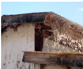
防鳥ネットの破れ・壁の破損
