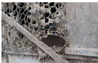
鶏舎開口部の金網の破損
